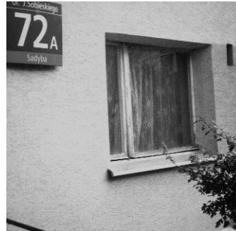
Swego czasu w budynku wymieniono okna. Nie wszędzie.
